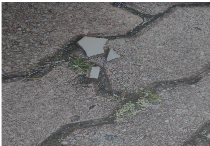
Foto 04 – Pastilha caída no entorno do prédio
